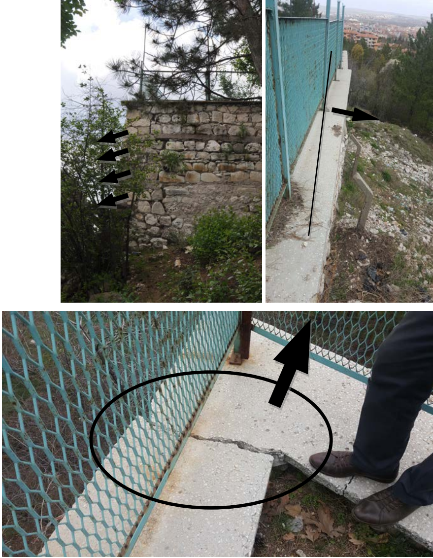
Şekil 3.2 İstinat duvarında gözlemlenen hasarlar
